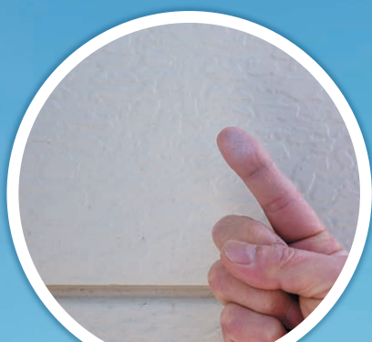
外壁を触ると 白い色が付く
