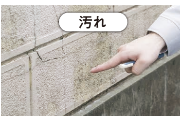
外壁を触ると白い粉がつく
